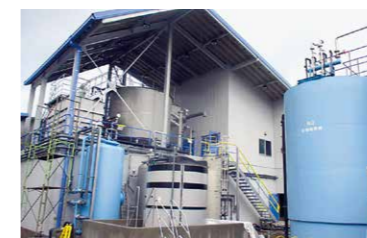
排水処理設備
